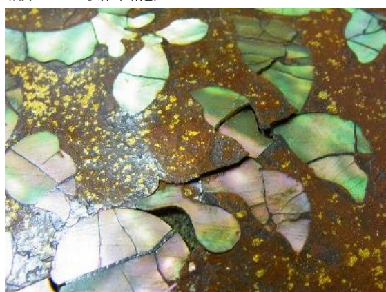
図版 210 天板の塗膜浮き
